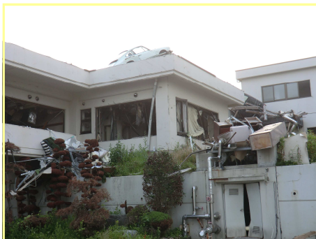
復旧の手が届いていない老人ホーム 屋上にはまだ自動車が
